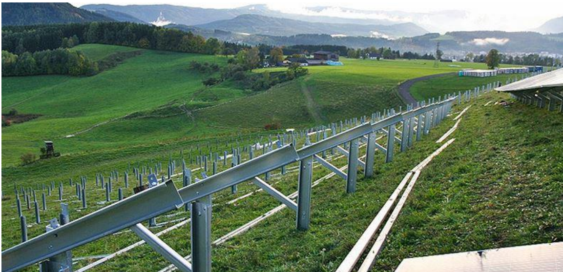
Zdjęcie 10 Konstrukcja przeznaczona do posadowienia paneli fotowoltaicznych.
