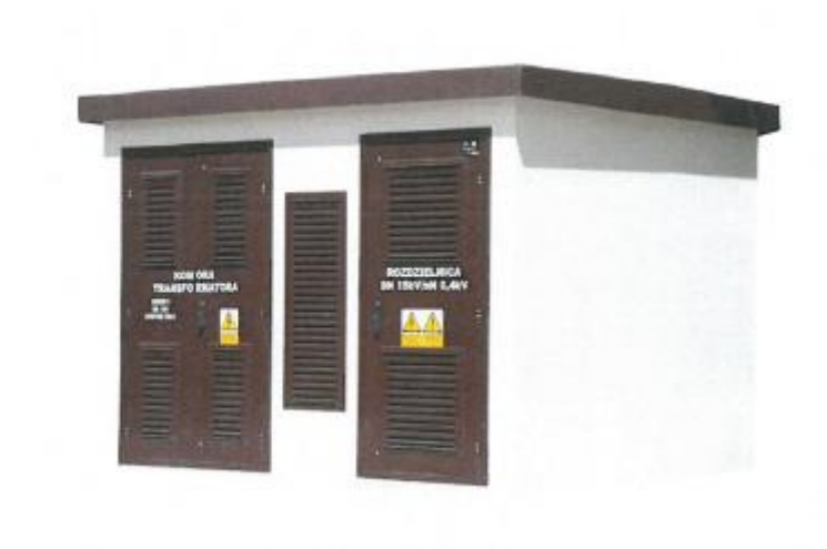
Zdjęcie 12 Przykładowa stacja transformatorowa.
