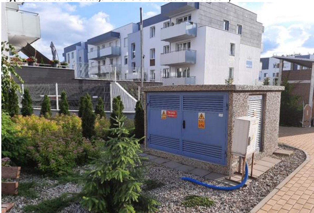
Zdjęcie 14 Standardowa stacja kontenerowa w otoczeniu zabudowy.
