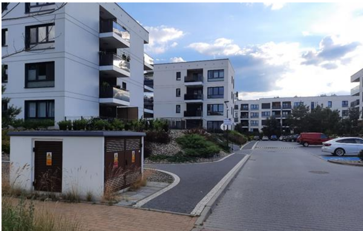
Zdjęcie 13 Standardowa stacja kontenerowa w otoczeniu zabudowy.
