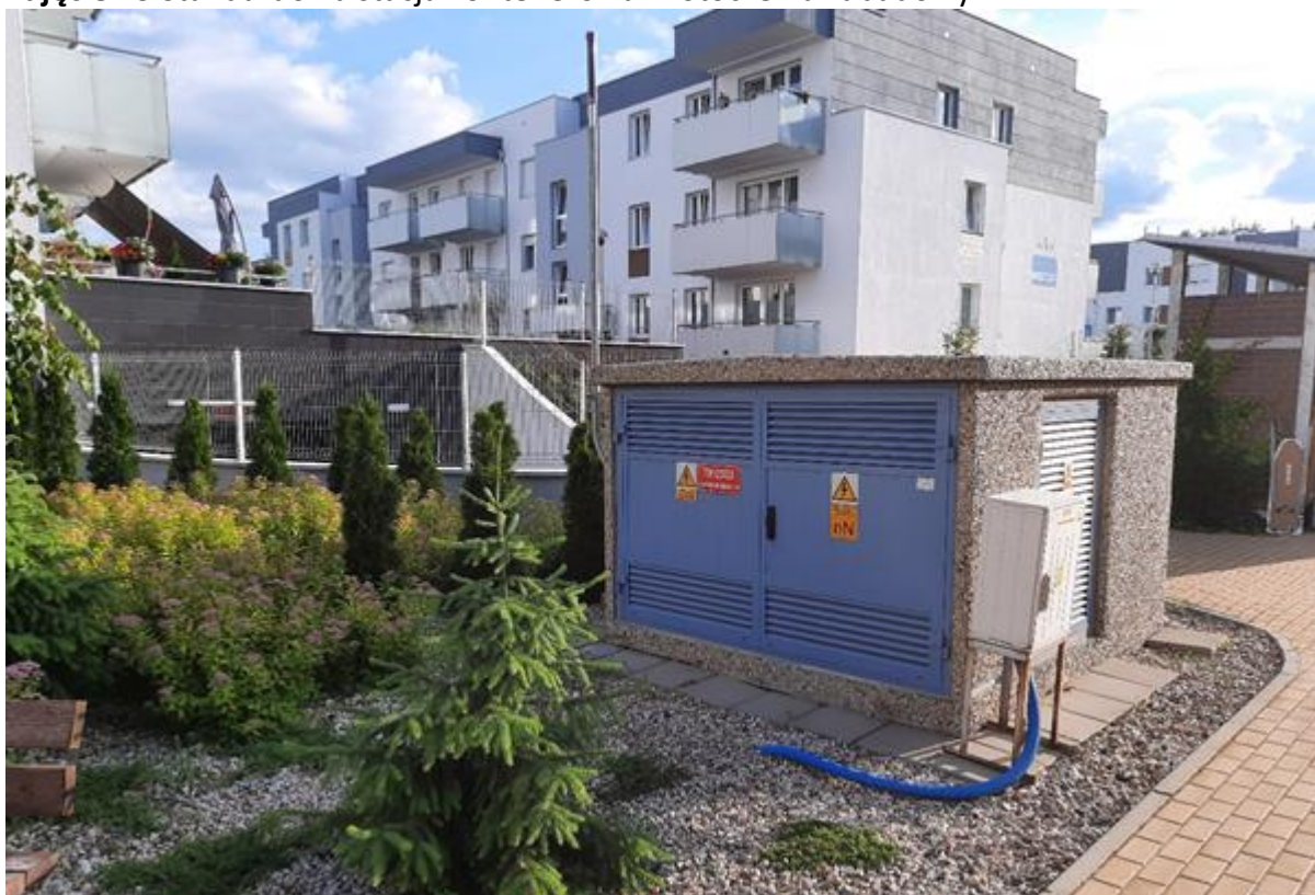
Zdjęcie 14 Standardowa stacja kontenerowa w otoczeniu zabudowy.
