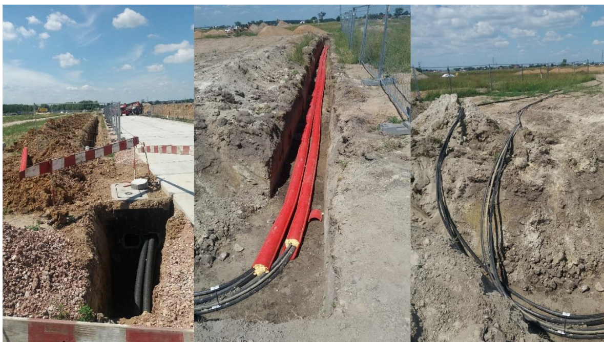
Rysunek 12. Przygotowanie terenu przeznaczony pod inwestycje na tzw. terenie północnym – stan czerwiec 2021r.
