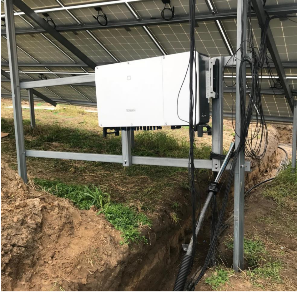
Ryc. nr 8 Przykładowy inwerter mocowany do konstrukcji wsporczej
