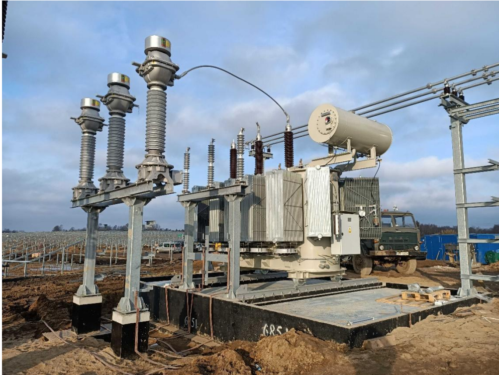
Ryc. nr 11 Przykładowe stanowisko transformatora z misą olejową
