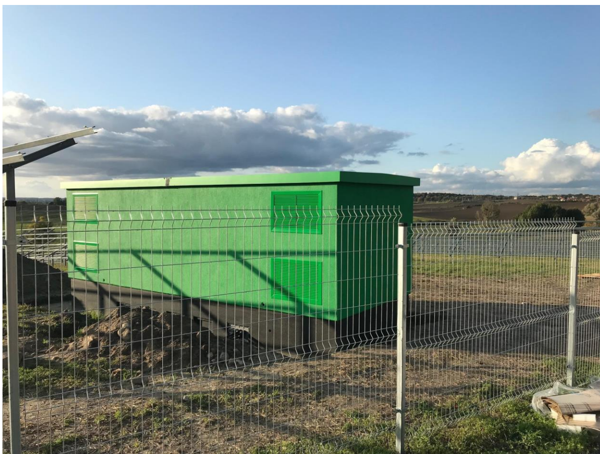
Ryc. nr 9 Przykładowa stacja transformatorowa
