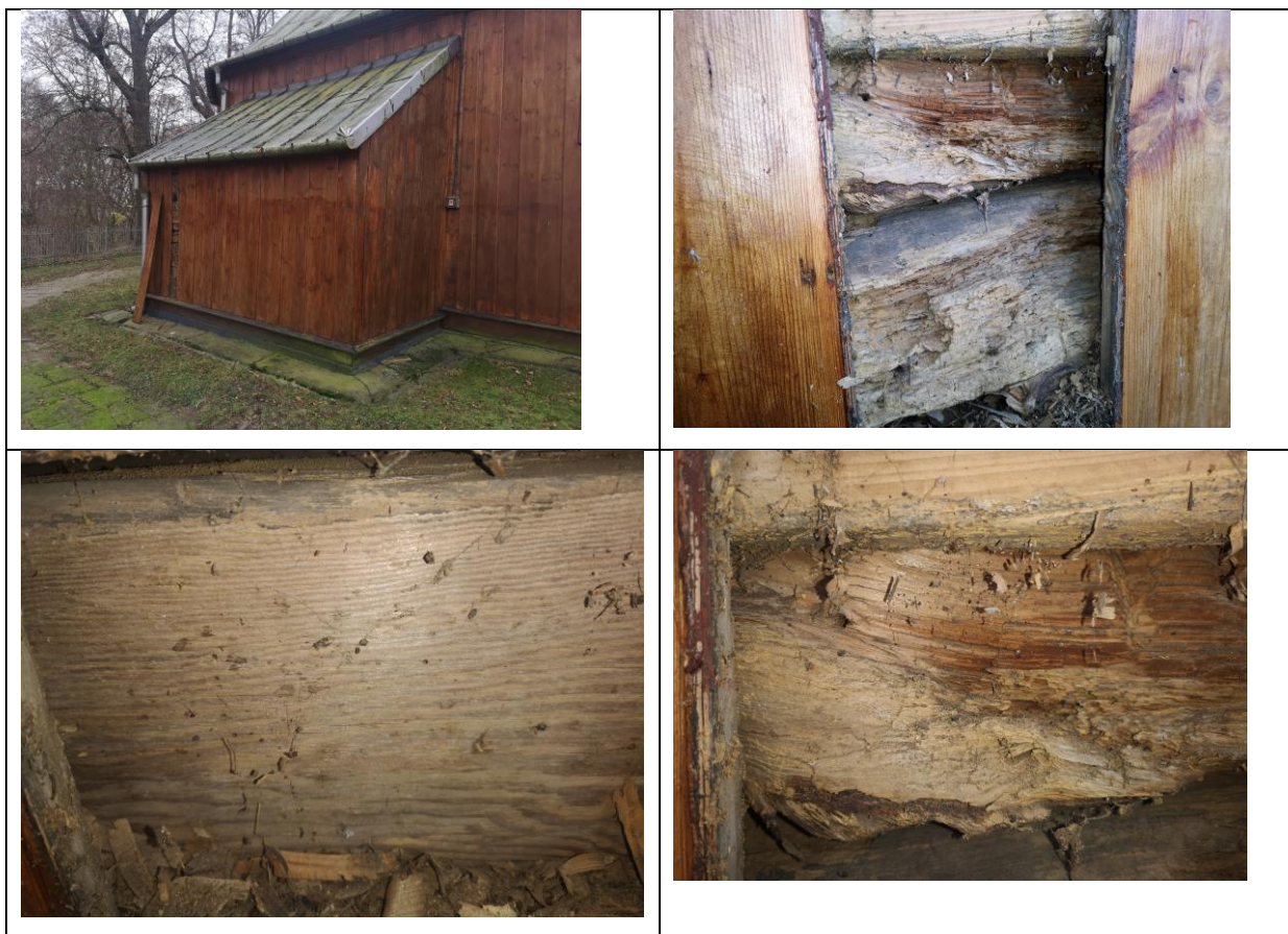
Fot.5.6-5.9 Miejsce wykonania odkrywki ściany zakrystii; widok bali ściennych porażonych przez grzyb domowy biały, spuszczała i grzyb domowy właściwy
