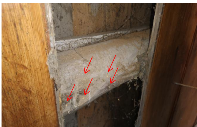
Fot.5.3. Belka poprzeczna szkieletowej konstrukcji ściany – aktywny proces żerowania owadów; ubytki do 50% przekroju; strzałkami oznaczono otwory wylotowe, z których wysypuje się mączka
