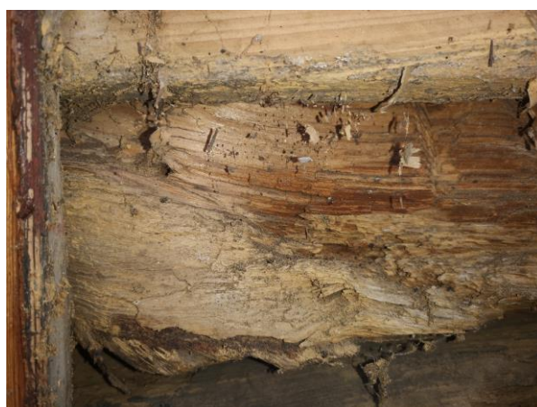
Fot.5.10 Belka ściany nad podwaliną porażona przez grzyb słupowy. Porażenie biologiczne ścian zakrystii ma charakter ogólny. Ściany zakrystii kwalifikują się do całkowitej wymiany. Wieżba dachowa niedostępna, ale ze względu na widoczne zapadliska połaci należy zakwalifikować ją do wymiany.
