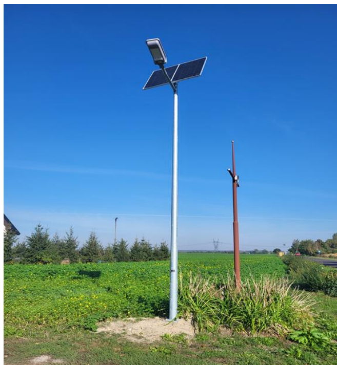
Oświetlenie uliczne solarne w miejscowości Kruszczewo
