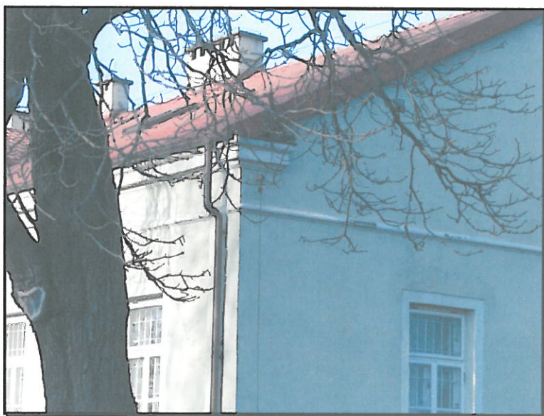
Zdj.9 Gzyms narożnikowy zredukowany.
