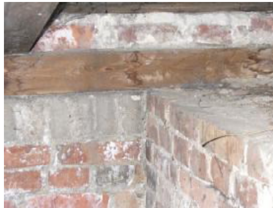
Fot. Nr 8 Widok ścian na uskoku stropu i murłaty na ścianie szczytowej
