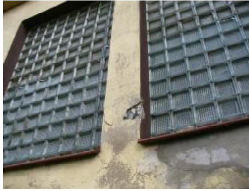
Fot. Nr 10 Filarek z gazobetonu przy naświetlach z luxferów
